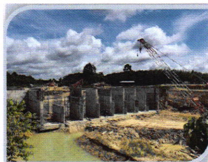
ระบบสูบน้ำและระบบส่งน้ำ MC1 พร้อมอาคารประกอบ
